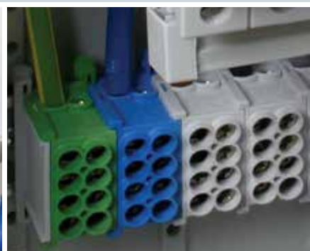
Las bornas permiten la conexión entre las diferentes líneas de suministro.
