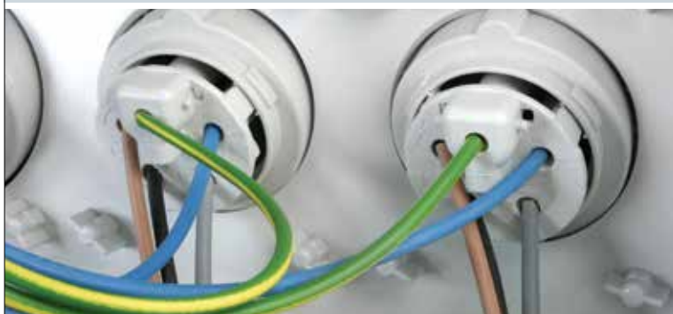
Amplio espacio para el cableado de las bases que se realiza según el REBT.
